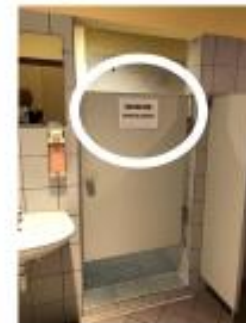
Sanitäreanlagen „Duschbereich“ Hinweis: „Gesperrt“
